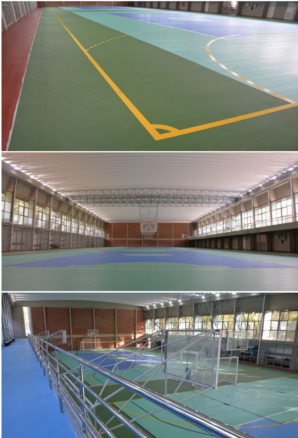
Resultado da reforma do telhado, dos pisos e do mezanino dos salões A, B, C e D.
