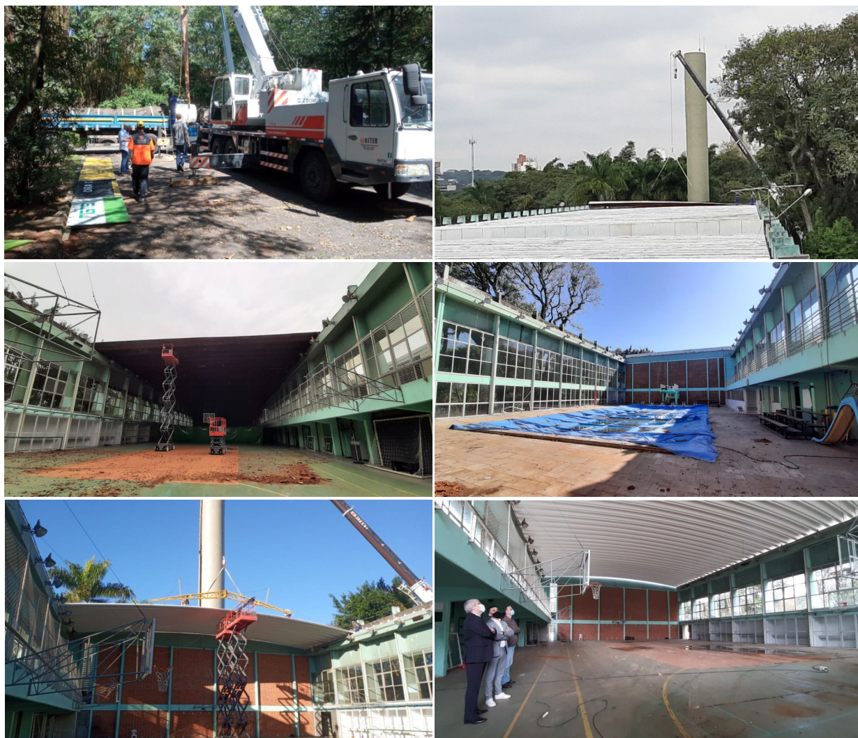
Etapas das obras de reforma da cobertura dos Salões A, B, C e D.
